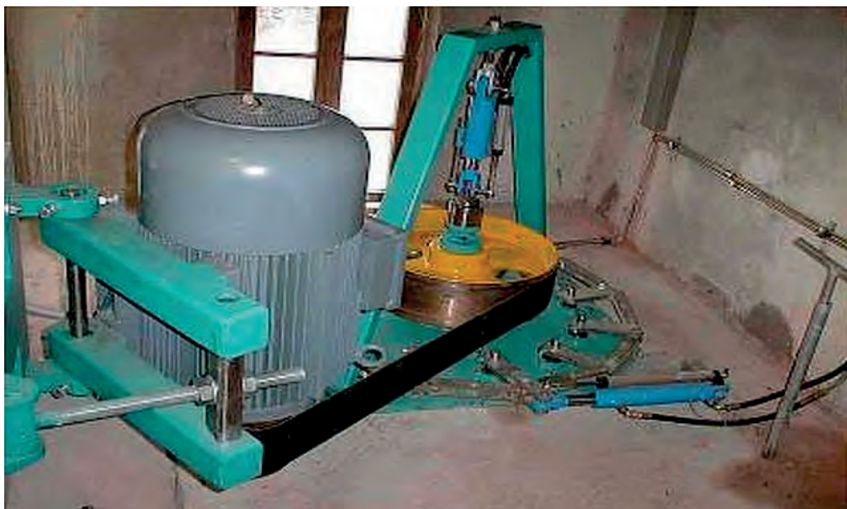
Obr. 10 Generátor s řemenovým převodem u svislé turbíny
